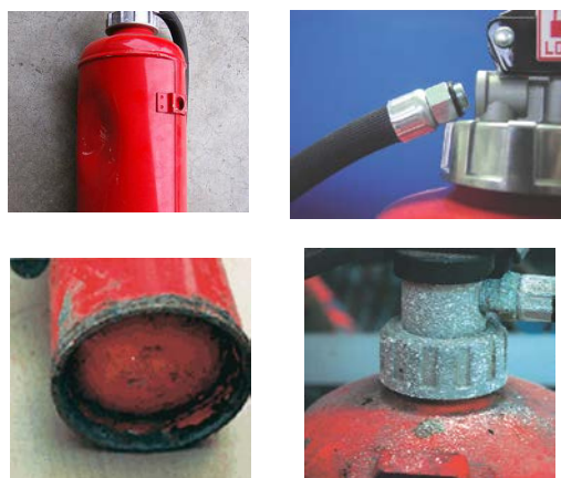
消火器の点検例（左上から時計周りでへこみ、ホースの欠落、キャップの腐食や破損、溶接部とその周辺の腐食）
